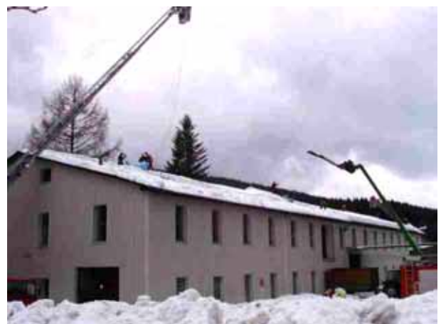
Die verbliebende Dachfläche musste mit Hilfe der Drehleiter aus Bad Kötzing vom Schnee geräumt werden.
