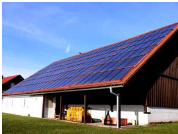
Sonnenkollektoren kombiniert mit einem Biomasseheizwerk
