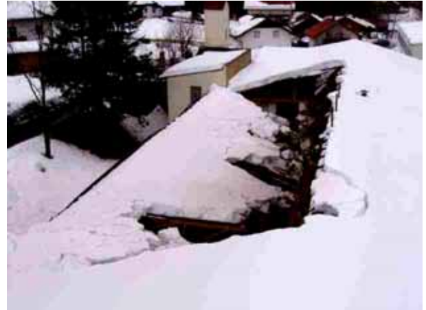
Einsturz einer Hälfte des Daches einer Lagerhalle in Schrenkenthal (Gemeinde Lohberg) auf einer Größe von ca. 40 x 10 m
