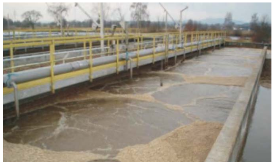
Belebungsbecken einer öffentlichen Kläranlage
